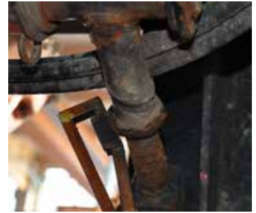
Bild 11: Rost zerstören ohne Glühen
